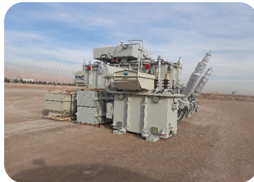
پست سیار ۳۰ مگاواتی برق
